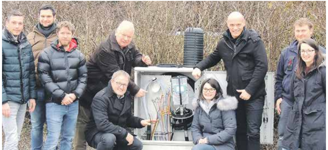
Die Verantwortlichen der Marktgemeinde Wies sowie die Umsetzungspartner DPB, Büro Kolar, Fionis und Xinon ziehen so lange am Breitband-Strang, bis auch das letzte Haus in der Gemeinde über eine schnelle Internetanbindung verfügt. 2021 soll die flächendeckende Anbindung geschafft sein.
