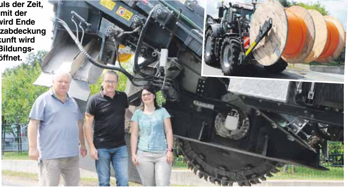
Dieses Trio bringt ganz Wies an den Datenhighway: Projektleiter Ing. Rainer Kolar, Bgm. Mag. Josef Waltl und Projektassistentin Karin Krieger (Büro Kolar). Bei den Grabungsarbeiten setzt man auf das moderne Fräsverfahren des Layjet – zur Verfügung gestellt vom Land Steiermark Abteilung A7 –, mit dem sich am Tag rund 1.500 Meter Kabel entlang der Straße problemlos verlegen lassen.
